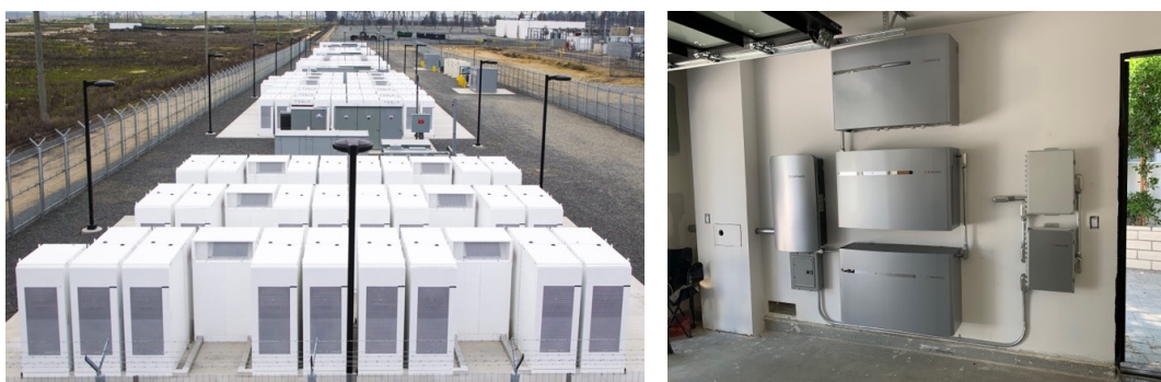
Figura 8.3 Izquierda: sistema de baterías conectado a la red eléctrica (Lambert, 2017), derecha: sistema de baterías casero (BVISolar, s.f.)
